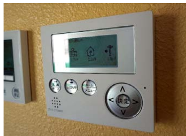
太陽光発電ユニット
